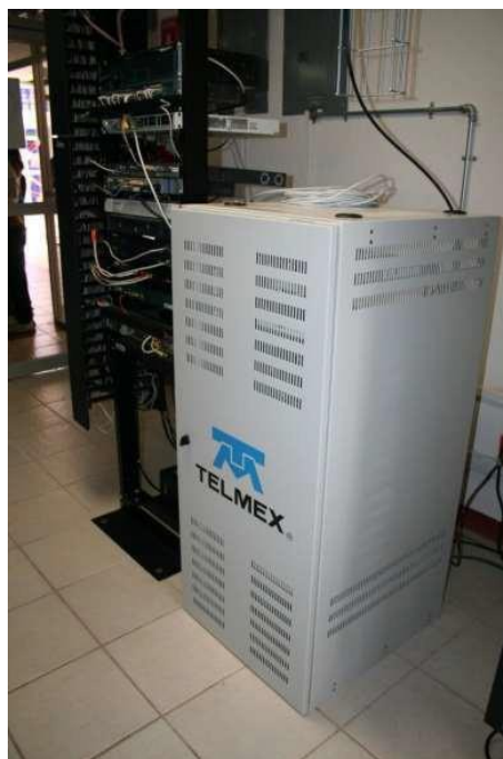
Figura 27. Equipo al que llega la fibra óptica y la señal de internet
