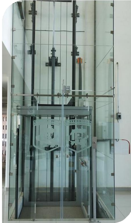
Ilustración 39 Elevadores Fuente. Elaboración propia
